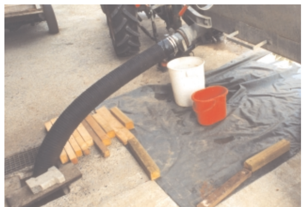
Abb. 2: Abpumpen des häuslichen Abwassers
