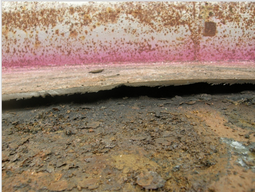
Bild K.6: Muldenkorrosion der Unterseite eines Tankbodens (ursprüngliche Dicke 10 mm)
